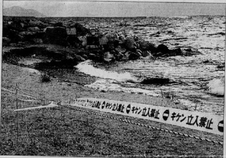
立入禁止ロープが張られた薩摩町の浜欠け現場
